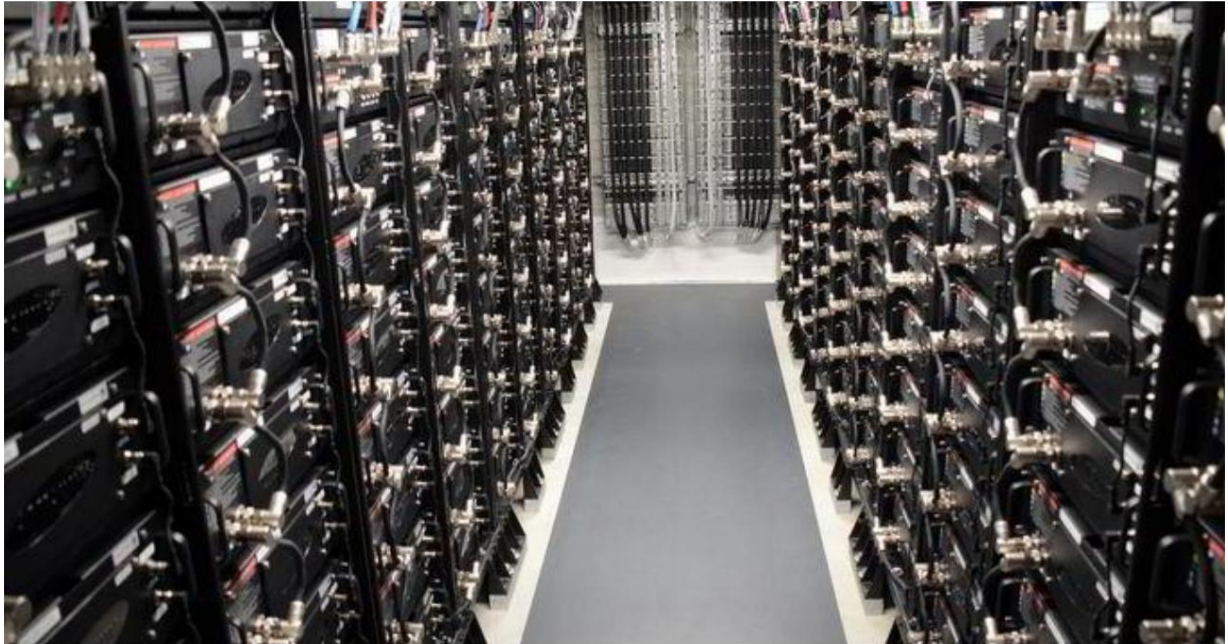
Sistem de baterii. Sursa: https://www.europower-energi.no .
