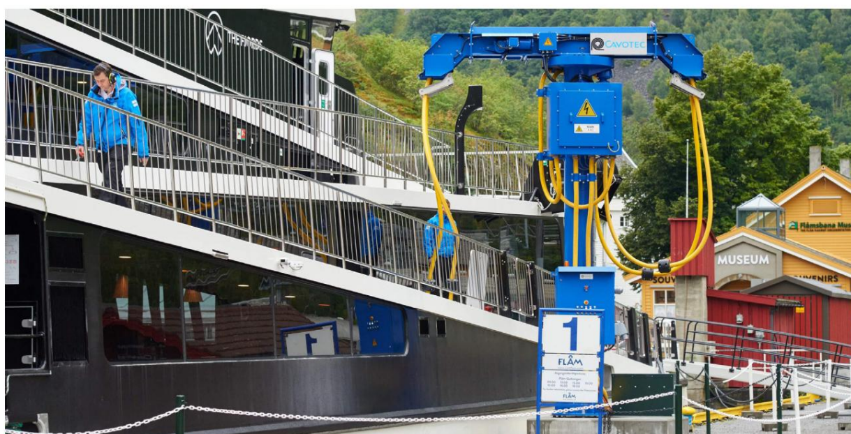
Conexiune de electricitate terestră controlată de la distanță pe chei în Flåm. Imagine: CAVOTEC.
