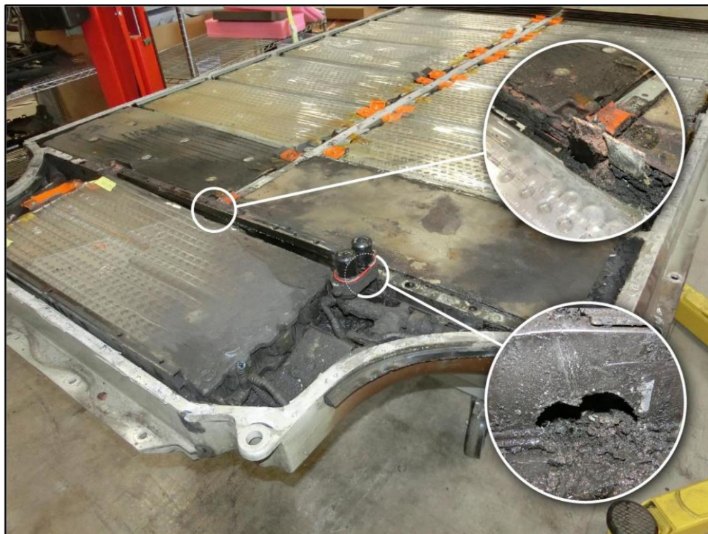
Figura 15. Pachet de baterii cu capacul superior scos pentru a arăta locația orificiilor în carcasa bateriei și inserții care arată în prim plan zonele deteriorate.
