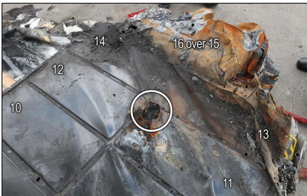
Figura 12. Suprafața superioară a părții anterioare a carcasei bateriei care arată deteriorarea față și orificiul topit prin capacul din oțel (încercuit), cu modulele numerotate.
